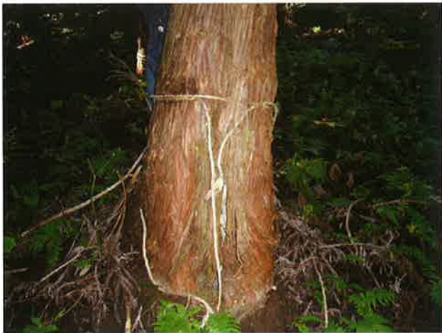
③対策劣化状況（荒縄切断）
